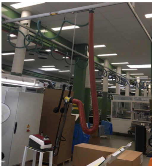
Figur 1: Vakuumløfteanlægget i RPC Superfos' fabrik i Taastrup
