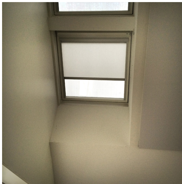
Vippevindue i tag til afkast af luft
